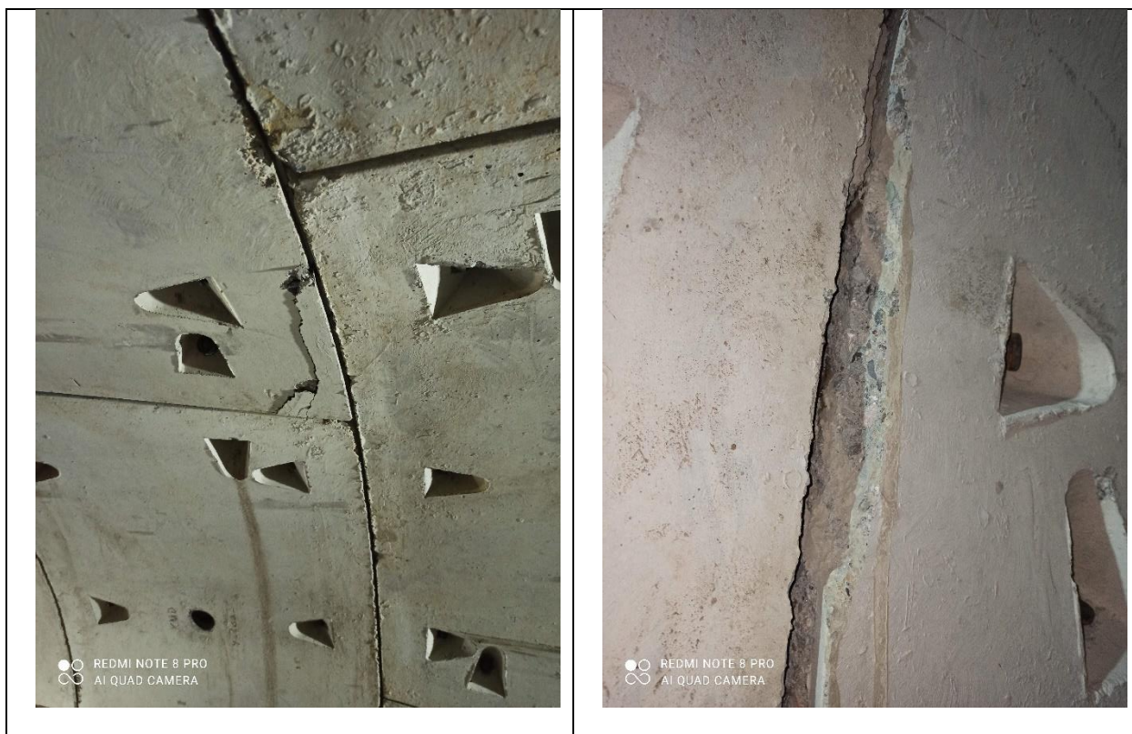
شکل (۱۱) - لبریدگی و شکست لبه سگمنتها در اثر تنشهای نامتقارن
