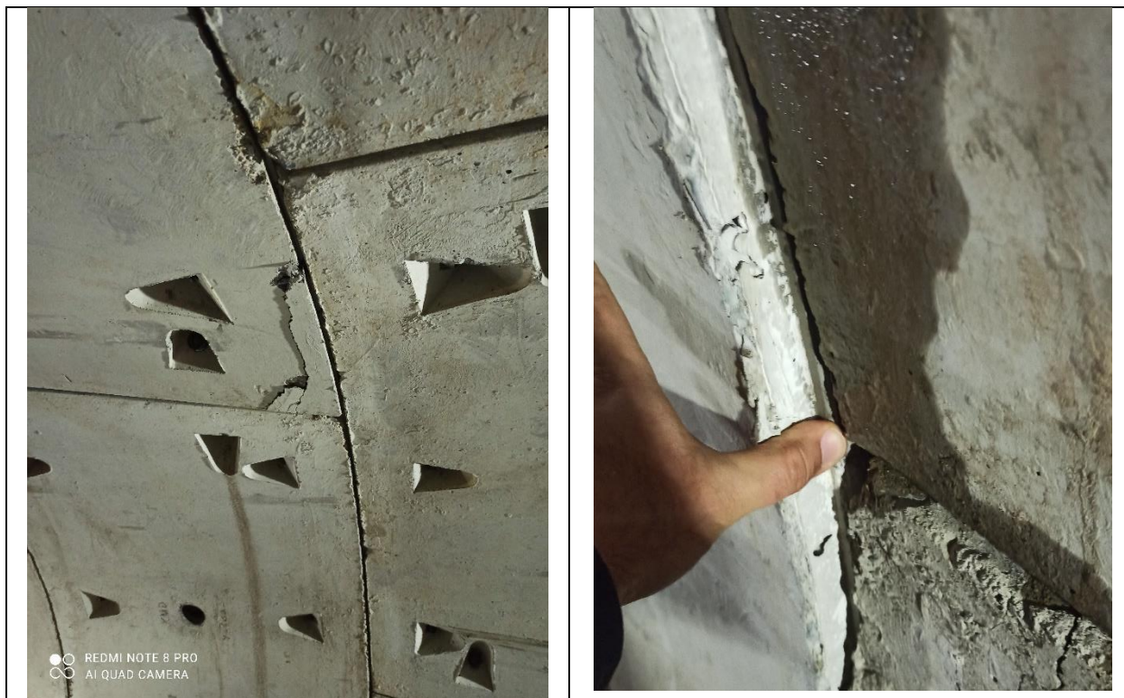
شکل (۱۰) - رواداری در نصب سگمنتها و عدم نصب پیچهای بین قطعات
