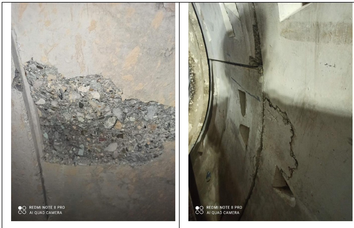
شکل (۷) - لایه لایه شدن و شکستگیهای کاور بتن سگمنتها
